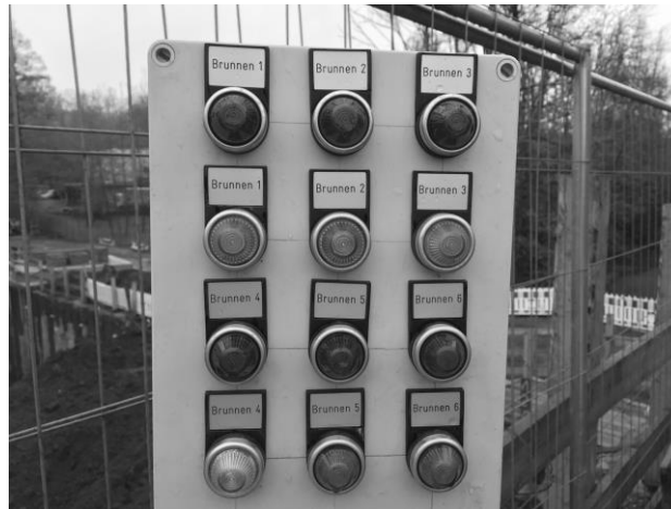
Abbildung 7: Schalttafel Pumpensteuerung für die 6 Förderbrunnen
