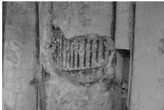
Abbildung 1: Unzureichende Betonüberdeckung bei einem stark bewehrten Bohrpfahl
